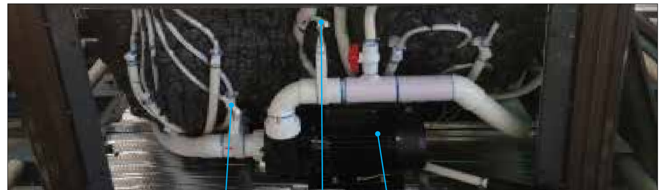
Schieberventil Schieberventil Pumpe
